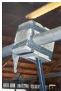
Slika 4: Zaščita vodovodne napeljave
